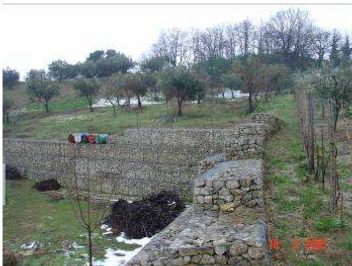
Foto n° 2 – Muri in gabbioni a monte del fabbricato Formidabile. Si osserva il vistoso spanciamento delle strutture con traslazione in avanti. Fase iniziale del movimento franoso
