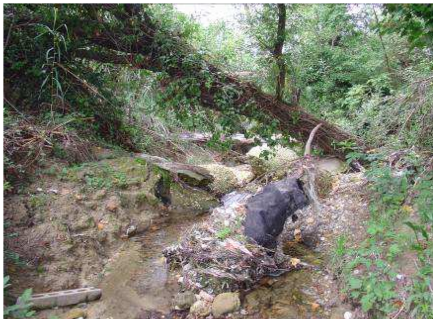
Tratto di alveo in cui si osservano sia i resti di una briglia in calcestruzzo, sia l'accumulo in sponda sinistra di materiale argilloso e conci di mattoni
