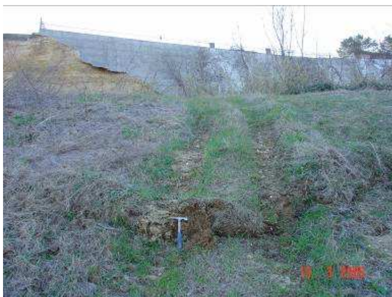
Foto n° 13 – Lesione nel terreno molto a valle della parete in gunita. Ciò denotava come la frana era molto estesa e senz'altro preesistente all'evento che si descrive
