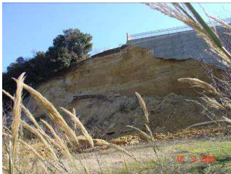
Foto n°11 – Vista frontale del crollo del lato Nord della parete in gunita. Si osserva un tubo corrugato in un foro drenante realizzato dietro la parete franata.
