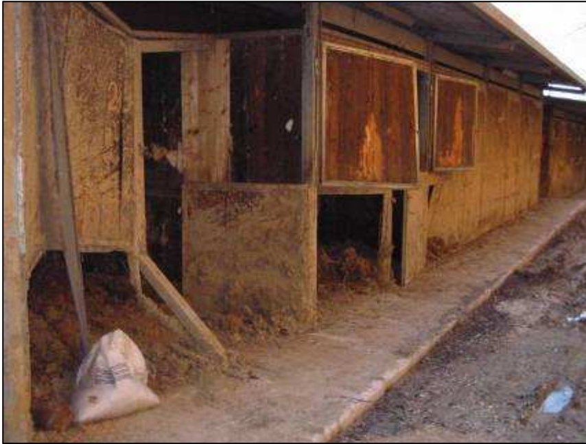
Fig.21 Danni alle scuderie provocati dalle colate e dal crollo di blocchi arenacei.
