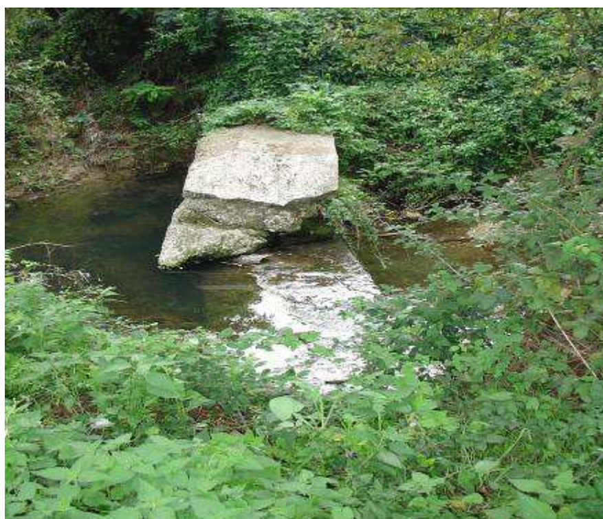
Particolare di una briglia in calcestruzzo resa ormai inservibile
