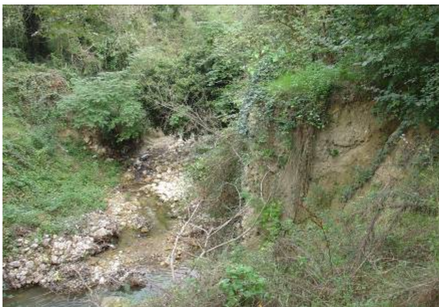
Briglia distrutta. Rimangono, in parte, le sole spalle in gabbioni
