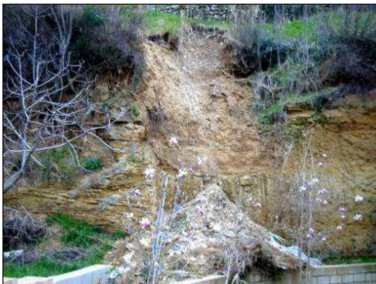
Fig.23 Crollo di detrito e terreno di riporto.
