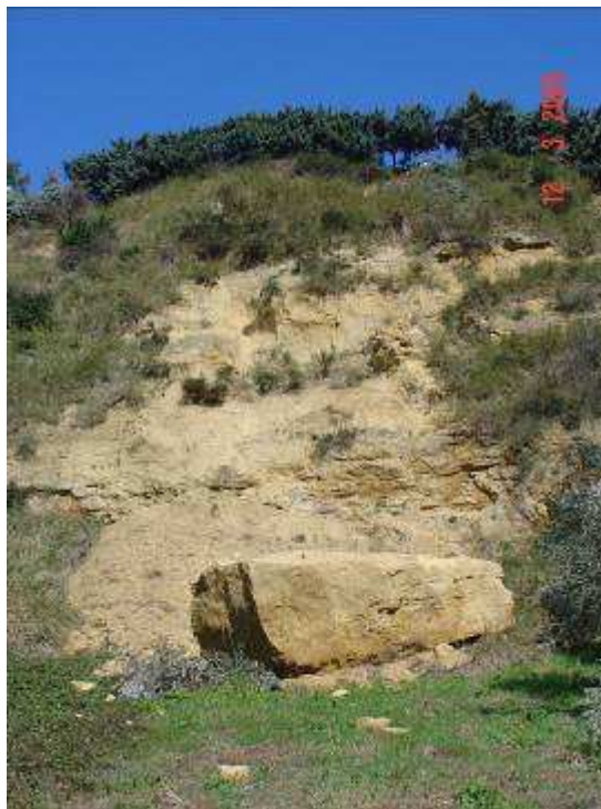
Foto n°19 – Crollo di un grosso blocco di roccia sabbioso – arenacea sotto Via Panoramica
