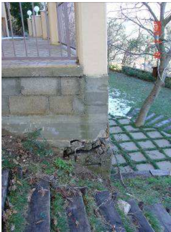
Foto n°4 – Particolare della frattura nel terrazzino dei signori Giancristofaro costruito su riporto a tergo muro in c.a. che, all'atto della fotografia, è ancora integro
