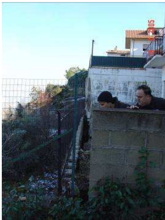
Foto n°3 – Il muro sottostante il palazzo di 5 piani durante l'ispezione dei Vigili del Fuoco
