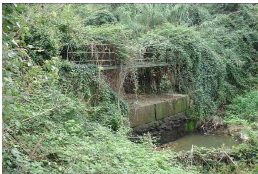
L'abbandono e l'incuria del territorio hanno reso inservibile un ponticello metallico costruito per attraversare il fosso. La soglia della briglia è spaccata in due pezzi
