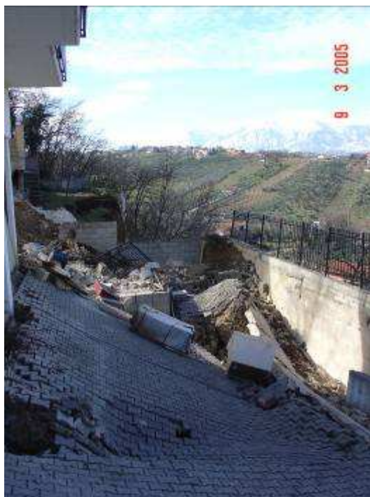
Foto n°7 – Avvallamenti e sprofondamenti a tergo del muro sbilanciato in avanti
