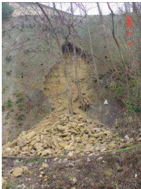
Foto n° 17 – Frana del tratto di muro antico ubicato in Lancianovecchia ( compreso tra Porta San Biagio alla sinistra e il parcheggio di Via per Frisa alla destra )
