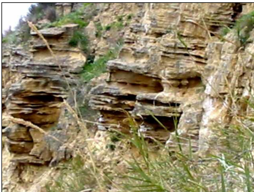
Fig.5 Particolare del versante con in evidenza le testate di strati arenitici. Sono visibili gli effetti dell'erosione eolica ed alcune fratture longitudinali che isolano blocchi instabili.
