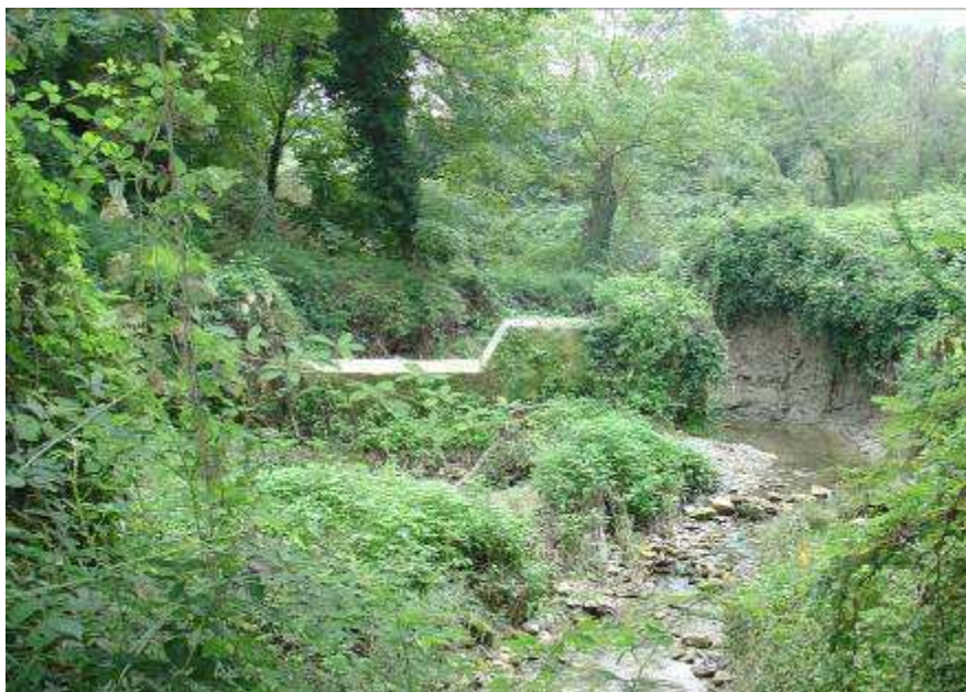
La confluenza del fosso Limaccio con il Malsano che avviene in sponda sinistra dello stesso. Si nota la briglia integra ma l'aggiramento della stessa ad opera delle acque
