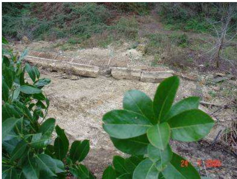
Foto n° 9 – Vista dall'alto. Il crollo della recinzione della casa Dr.Fazia, successivamente all'arretramento del crinale sabbioso
